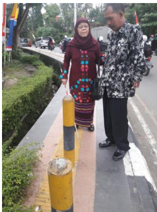
(kesalahan pemasangan guiding block di salah satu ruas jalan Kota samarinda)
